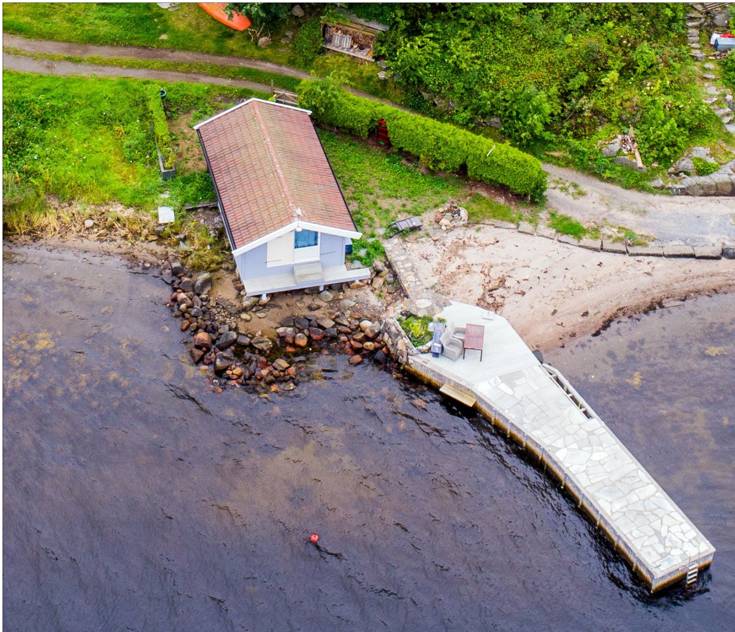
HAR REVET: Plattingen rundt båthuset er nå revet, og familien sier at de har revet også innvendig etter pålegg fra kommunen.
