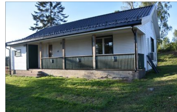
NY PRAKT: Speiderheimen hadde flistak med bølgeblikkplater over. Nå er det byttet ut med moderne takstein.
